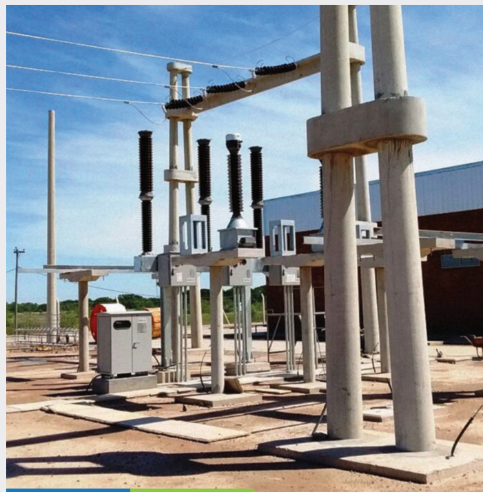
Estación transformadora La Leonesa - Las Palmas
