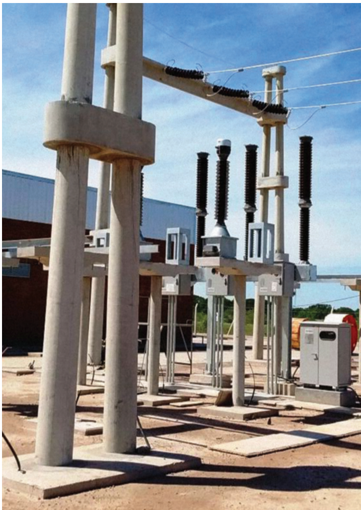
Estación transformadora La Leonesa - Las Palmas
